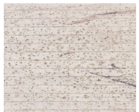
Stockflecken/Schimmel auf der Oberfläche
