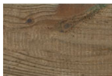
Rauhe Stellen auf der Holzoberfläche
