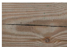
Spannungsrisse durch die Holz-trocknung
